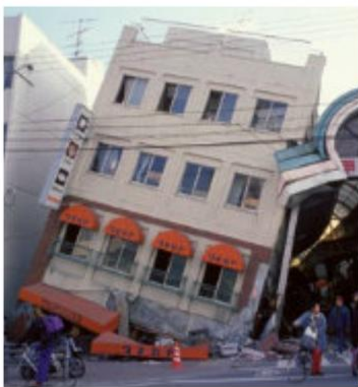
Skutki trzęsienia ziemi.
