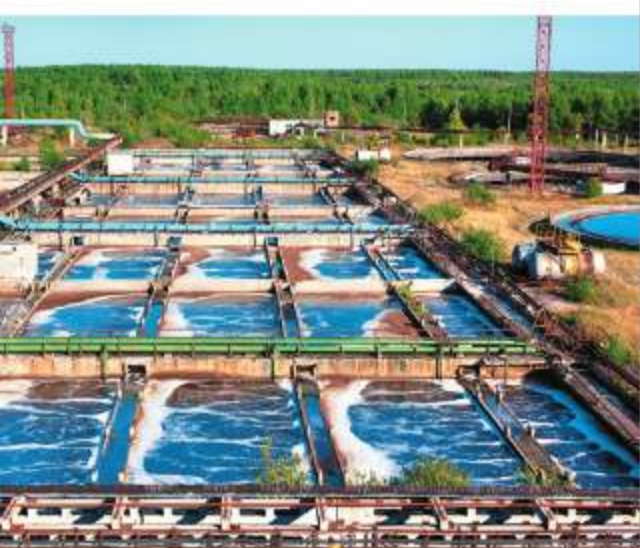
▲ Chemiczne oczyszczanie ścieków
