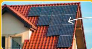
Instalacja fotowoltaiczna w woj. łódzkim
