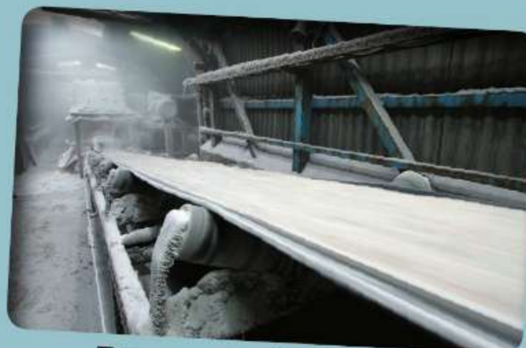
Transport soli taśmociągiem
