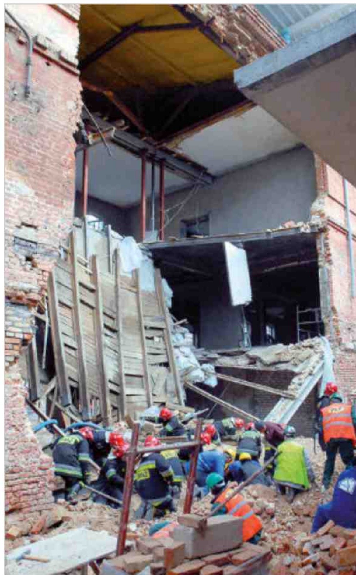
Akcja ratownicza po zawaleniu się budynku
