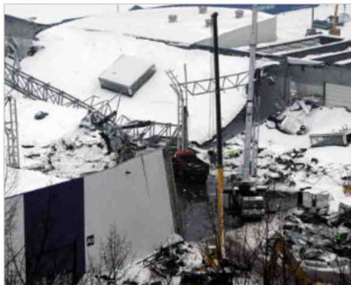
Stan po zawaleniu się hali MTK w Katowicach, 2006 r.
