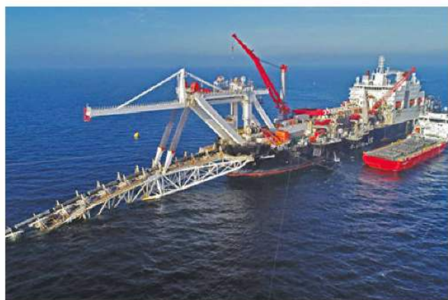
W 2021 r. ukończono budowę Nord Stream 2. Ma on 1230 km długości i biegnie z Wybarga (Rosja) do Lubmina (Niemcy). W ciągu roku można przetransportować tym rurociągiem 55 mld m 3 gazu ziemnego.
