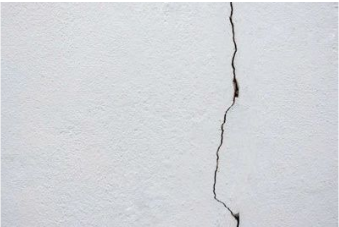
Rys. 3.17. Zdjęcie ściany z pęknięciem
